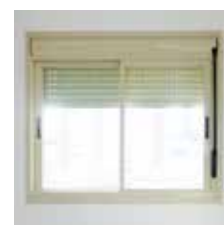
Persianas de enrolar nas janelas dos dormitórios, com previsão de automação
