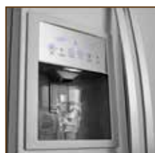
Ponto de água para geladeira na copa-cozinha
